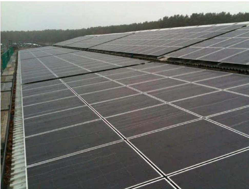
Photovoltaikanlage ca. 73 kWp in Vielank, Mecklenburg-Vorpommern, Belegung einer Kartoffel-Lagerhalle mit micromorphen Dünnschichtmodulen
