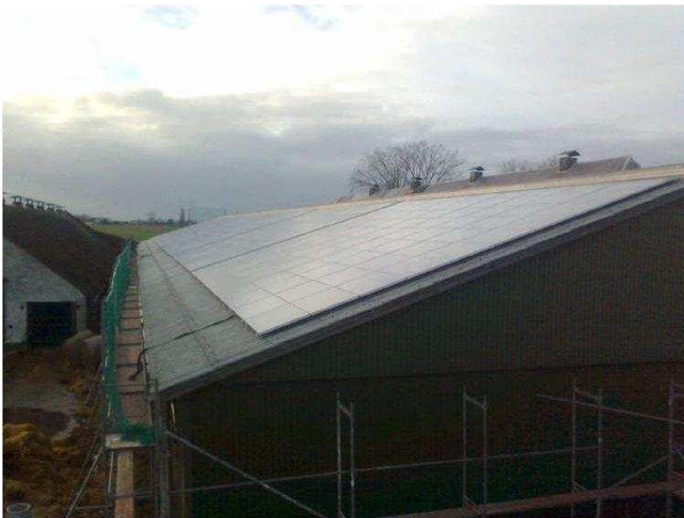
Photovoltaikanlage ca. 157 kWp bei Wolgast, Mecklenburg-Vorpommern, Belegung eines Kuhstalles mit polykristallinen Modulen und einer Lagerhalle mit micromorphen Dünnschichtmodulen
